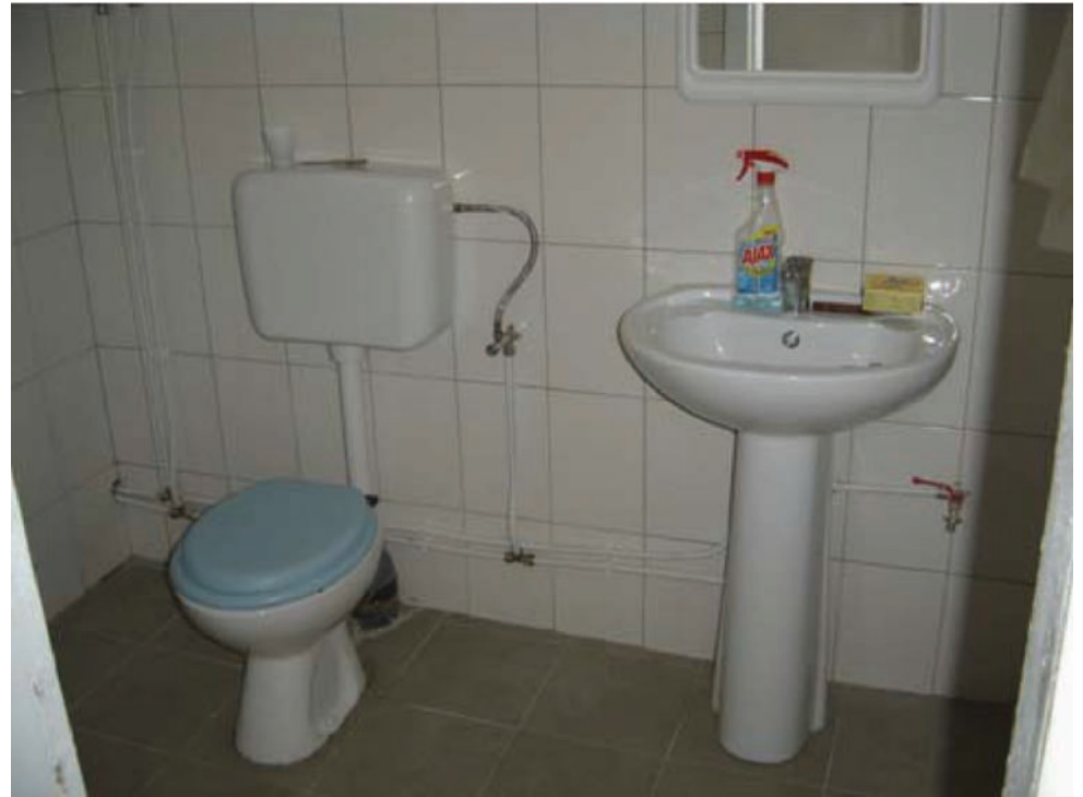
Toilet, nu in het schoolgebouw
